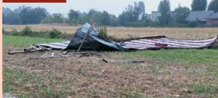
Wiatr zerwał dach z budynku. Fot. OSP Laski
